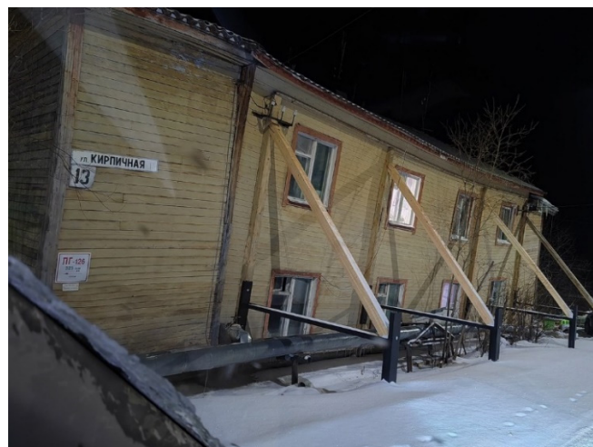
Рис. 2. Аварийная деформация эксплуатируемого здания на многолетнемерзлых грунтах.
